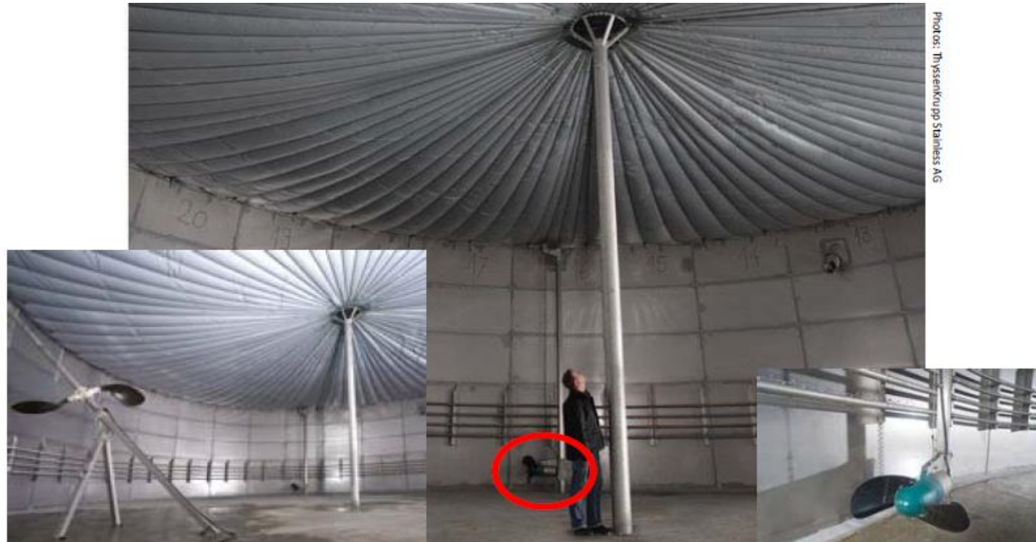
Σχήμα 3: Το εσωτερικό της κύριας δεξαμενής. Διακρίνονται η εύκαμπτη οροφή και ο αναδευτήρας, καθώς και οι σωληνώσεις που μεταφέρουν θερμότητα στο μείγμα (Chair of Bioprocess Engineering, TU-Berlin)
