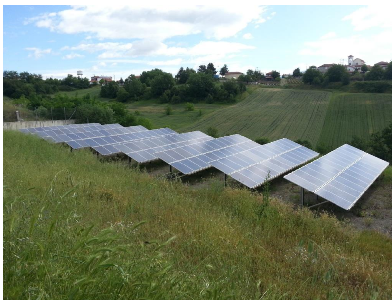
Σχήμα 1: Φ/Β πάρκο 100 kW (μερική άποψη) – (Κ-Ενεργειακή ΑΕ).
