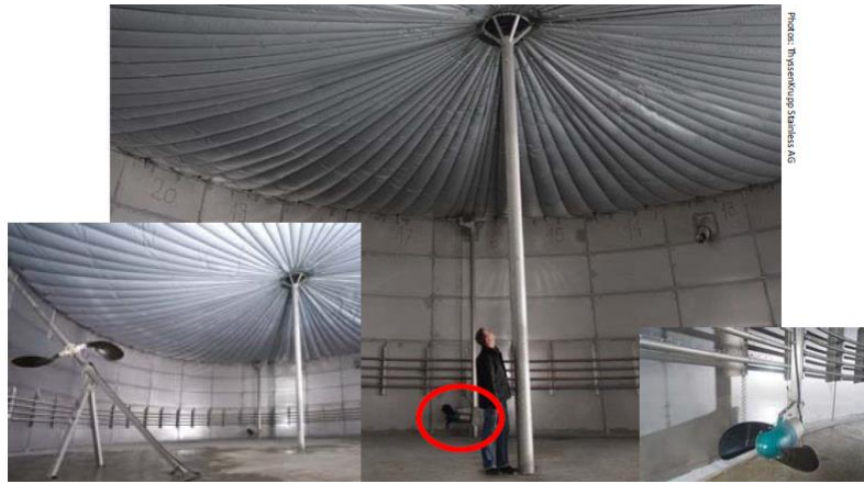
Σχήμα 5: Το εσωτερικό της κύριας δεξαμενής. Διακρίνονται η εύκαμπτη οροφή και ο αναδευτήρας, καθώς και οι σωληνώσεις που μεταφέρουν θερμότητα στο μείγμα (Chair of Bioprocess Engineering, TU-Berlin)
