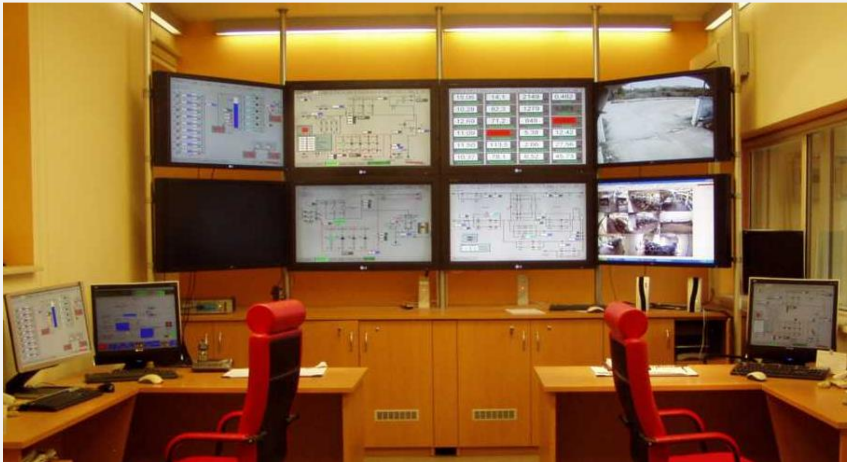
Ο Κεντρικός Σταθμός Παρακολούθησης του δικτύου ΤΗΛΕΘΕΡΜΑΝΣΗΣ ΚΟΖΑΝΗΣ
